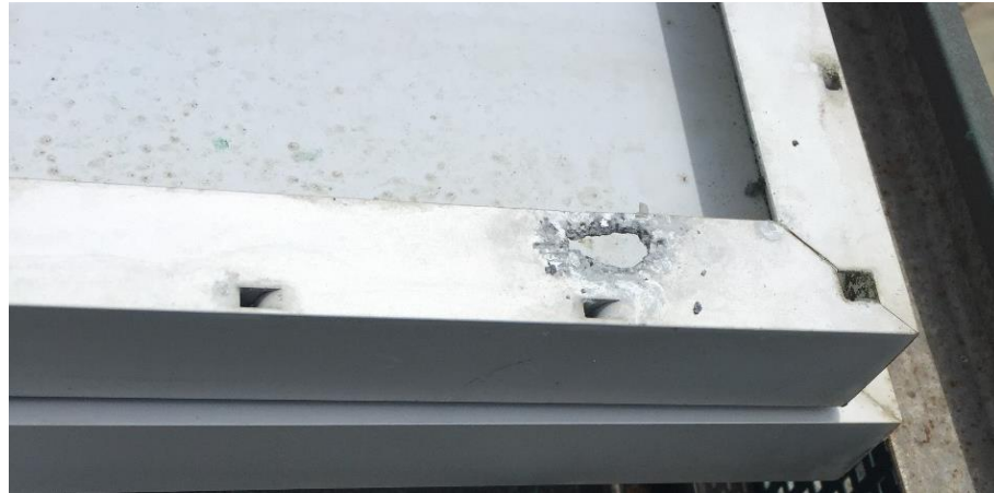
Figura 7.37. Corrosión severa en un punto del marco 13
