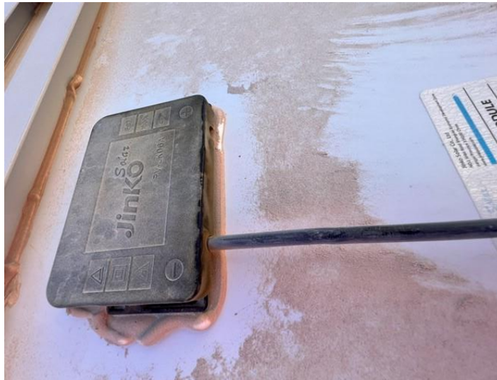
Figura 7.17. Módulo con un cable faltante.
