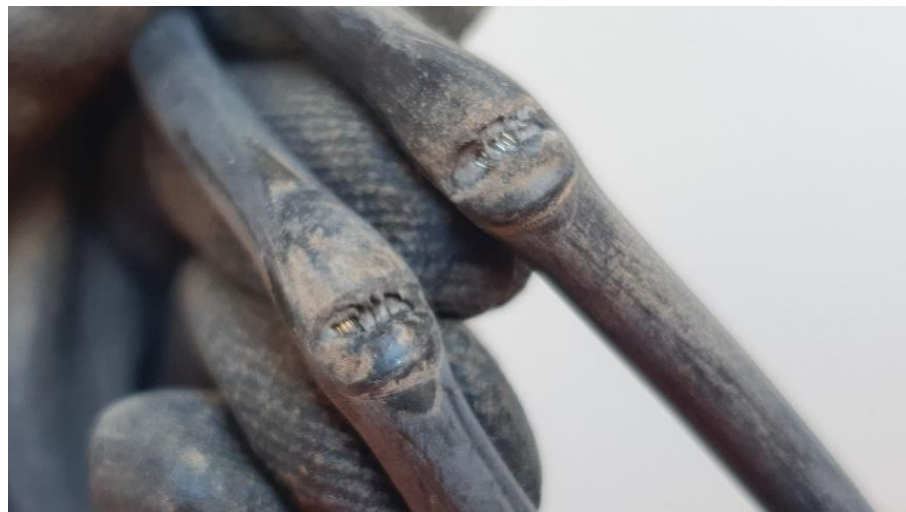
Figura 7.21. Cable agrietado con una rotura en el aislamiento
