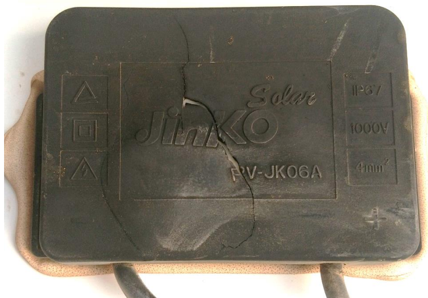
Figura 7.29. Junction Box agrietada.
