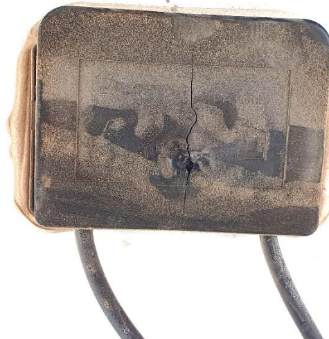
Figura 7.32. Tapa de la Junction Box agrietada.
