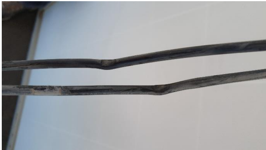
Figura 7.18. Cables aplastados, aún flexibles (desgastados).
