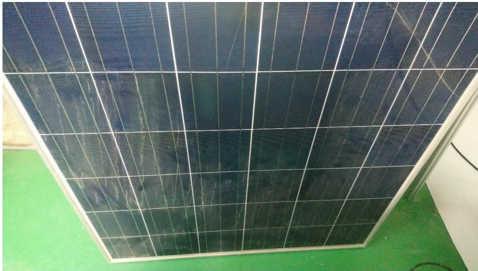
Figura 3.3. Módulo con suciedad en la cara frontal.
