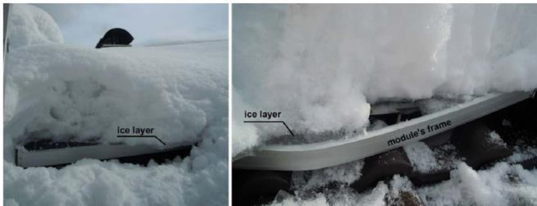
Figura 7.35. Marco doblado debido a la acumulación excesiva de nieve 12
