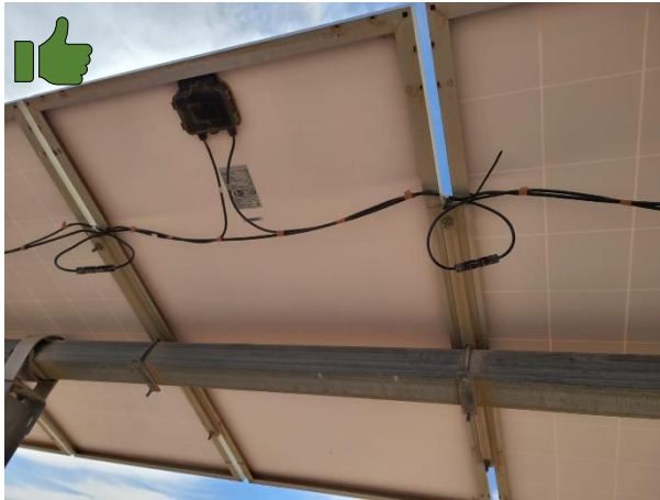
Fig. 7.9 Cables sujetos al marco de los MFV mediante amarras plásticas
