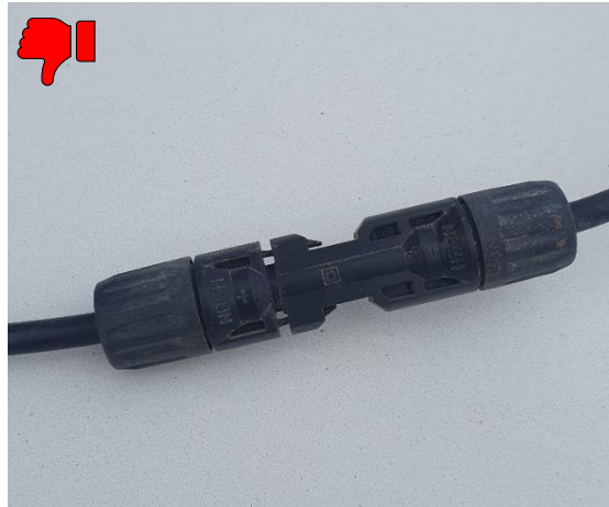
Fig. 7.11 Conectores MC4 conectados, pero no asegurados 30
