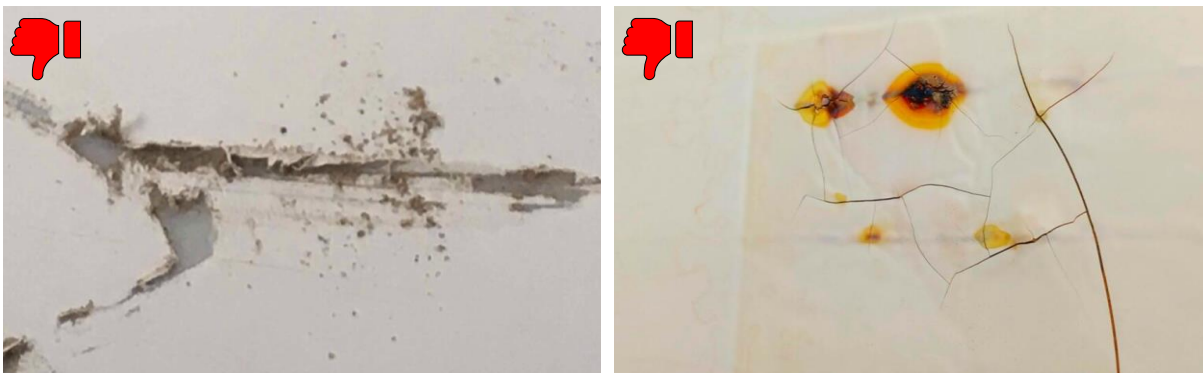
Fig. 7.5: Capa base con daño por golpe (izquierda) y daño por quemadura (derecha) 24
