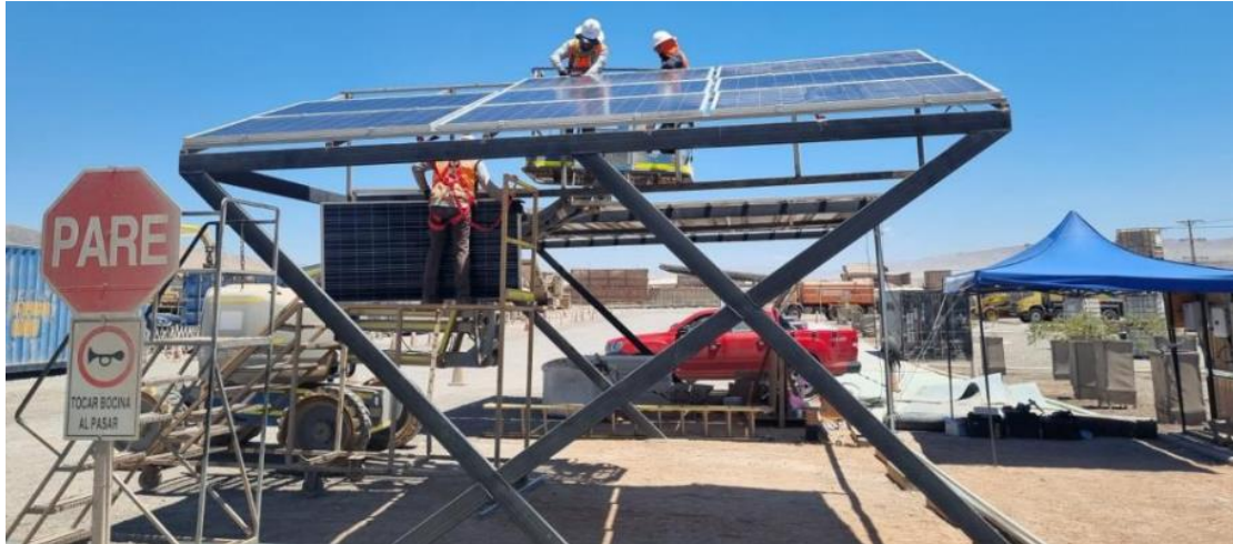
Fig. 10.16: Sistema fotovoltaico Servilinares.
