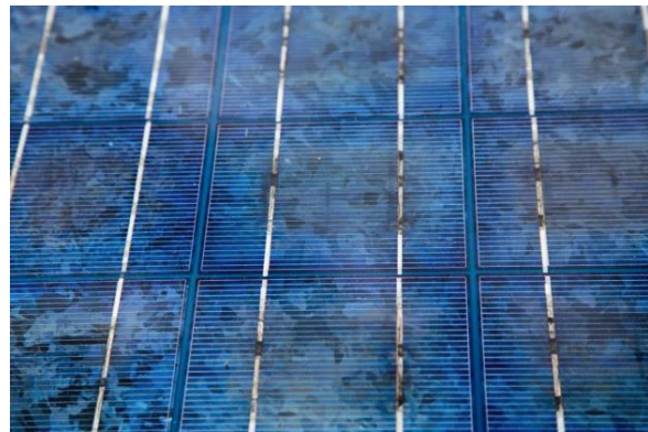
Fig. 6.8: MFV con marcas de corrosión en la metalización.
