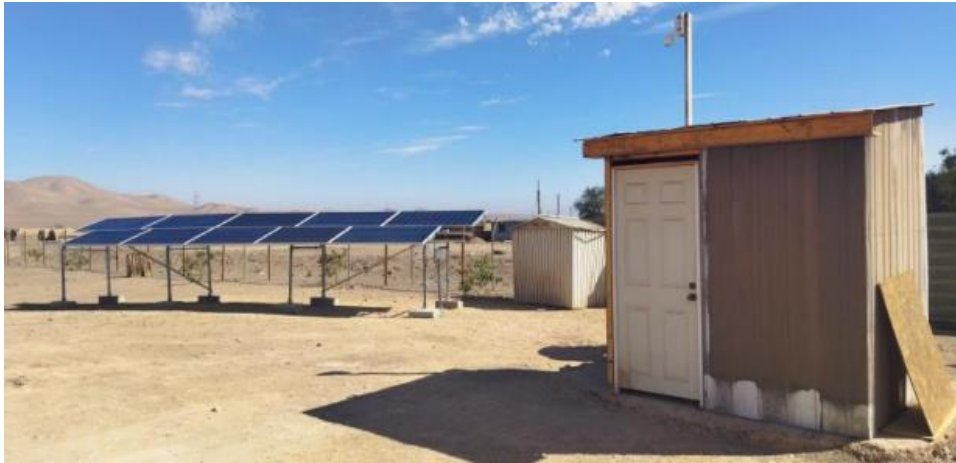
Fig. 10.18: Sistema fotovoltaico Desierto Verde.
