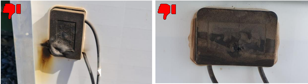
Fig. 7.4: Junction box con evidente daño por quemadura (izquierda) y daño en la tapa (derecha) 23
