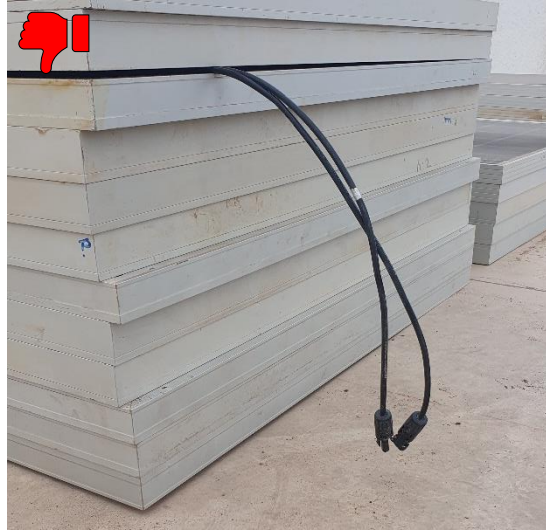
Fig. 6.14: Cables atrapados entre 2 MFV dentro de una pila
