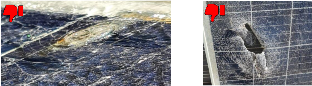
Fig. 7.6: Daño por golpe de en MFV 25 .
