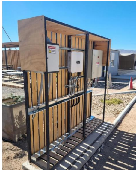
Fig. 10.17: Estructura asociada a instalación de los tableros de protecciones eléctricas y de supervisión (iATAMO-Cloud), como también inversor Huawei.
