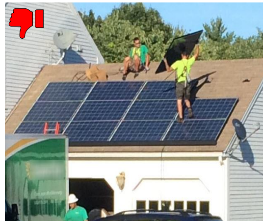
Fig. 6.4: Instalador parado sobre MFV y transportando un MFV de manera incorrecta 20
