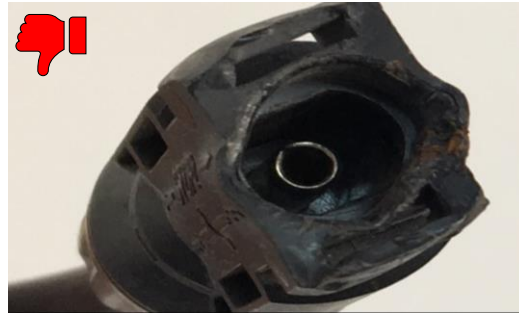
Fig. 7.2: Conector MC4 con daño visible.
