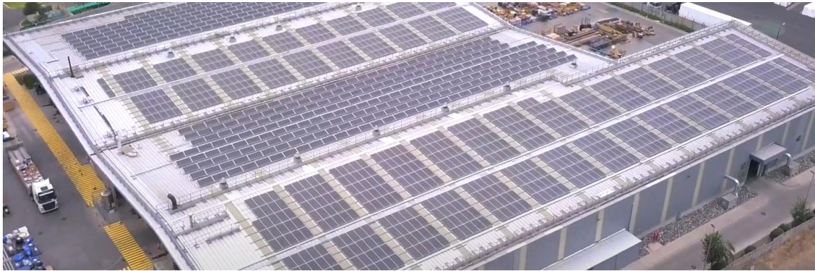
Fig. 10.8: Instalación fotovoltaica en Komatsu Reman Center Santiago. 42
