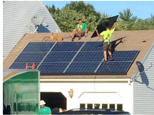
Fig. III.4. Instalador parado sobre MFV y transportando un MFV de manera incorrecta 9
