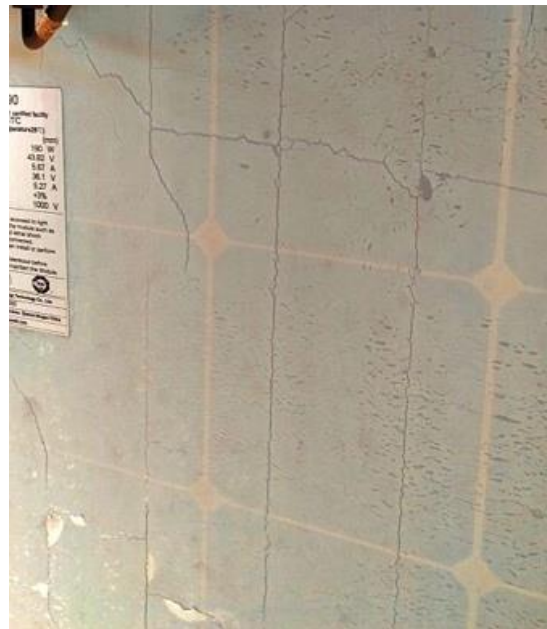
Fig. II.11. Rotura parcial de la backsheet 6
