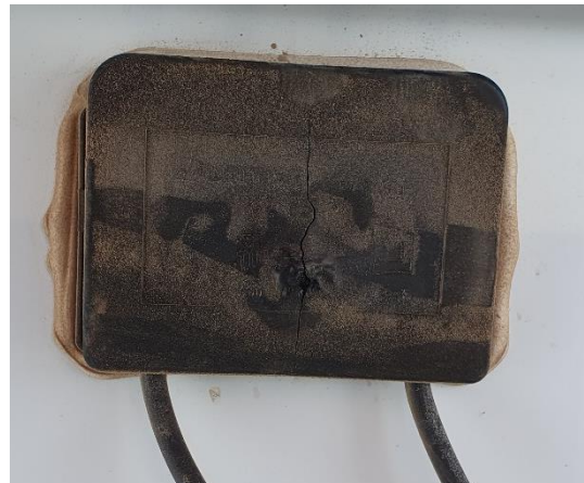
Fig. II.5. Jbox rota por un fenómeno térmico
