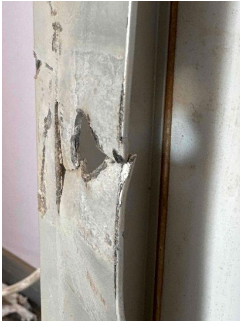
Fig. II.6. Rotura en el marco de un MFV
