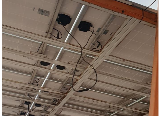
Fig. IV.4. MFV instalados y con sus cables colgando libremente
