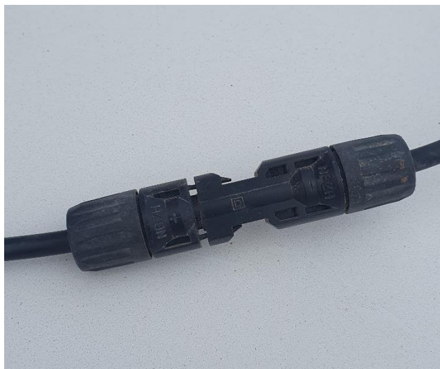
Fig. IV.5 Conectores MC4 conectados, pero no asegurados
